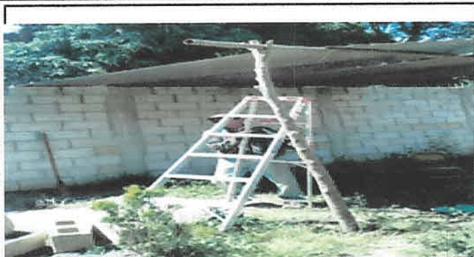
Foto 1: Módulo 1 desmontaje de la galera debido a que esta en deterioro y ya no cumple con la finalidad para la cual fue construida.
